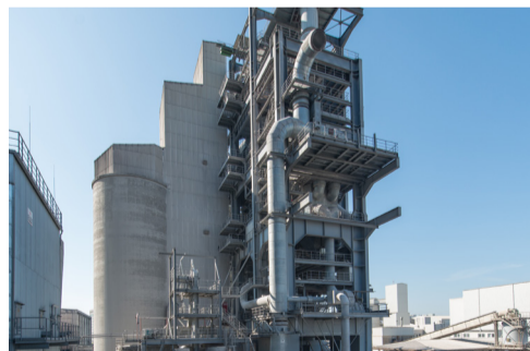
Zementwerk Amöneburg - Drehofenanlage mit Wärmetauscher
