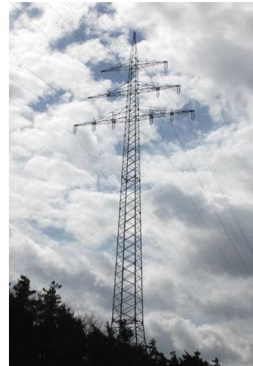
Abbildung 3: Mast im Abschnitt 2 (gut zu erkennen der freie Gestängeplatz oben links)
