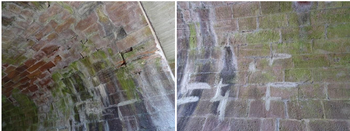
Abb. 23: Erkennbar offene und verschlossene Mauerspalten.
