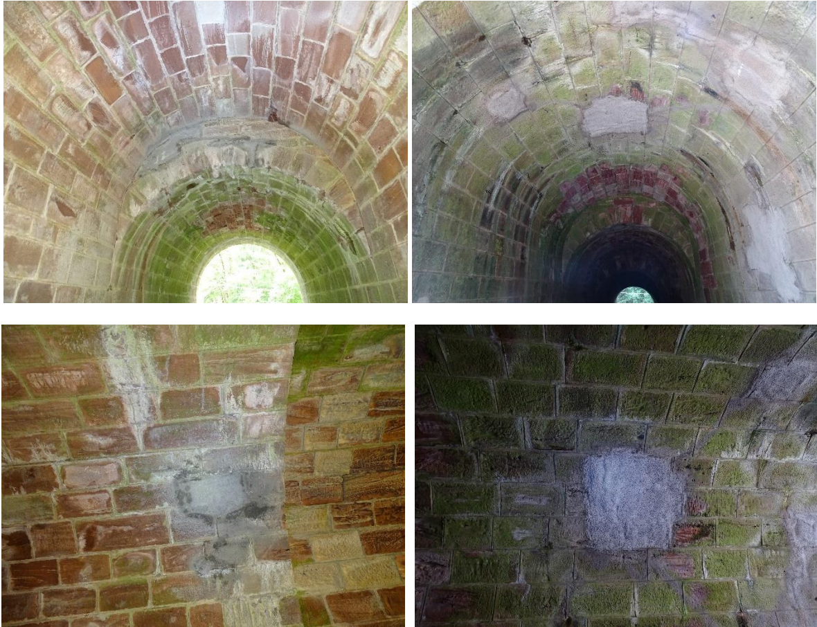
Abb. 42: Zustand nach Sanierung mit Beispielen verputzter und ausgefugter Fledermausverstecke (erkennbar am hellen Mörtel).
