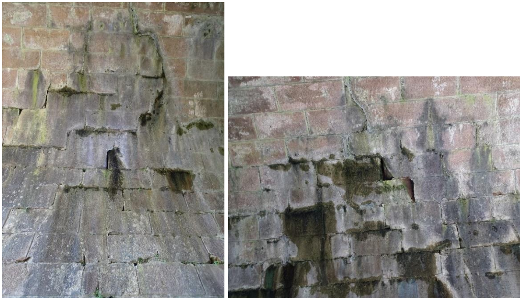
Abb. 17: Aktueller Zustand vor der geplanten Sanierung. Zu erkennen sind Spalten im Mauerwerk, die von Fledermäusen besiedelt werden können.
