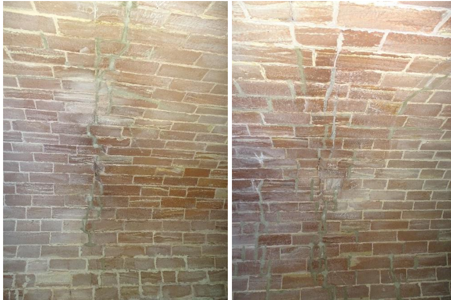
Abb. 59: Beispiele verputzter und verfugter ehemaliger Fledermausverstecke (erkennbar am hellen Mörtel).
