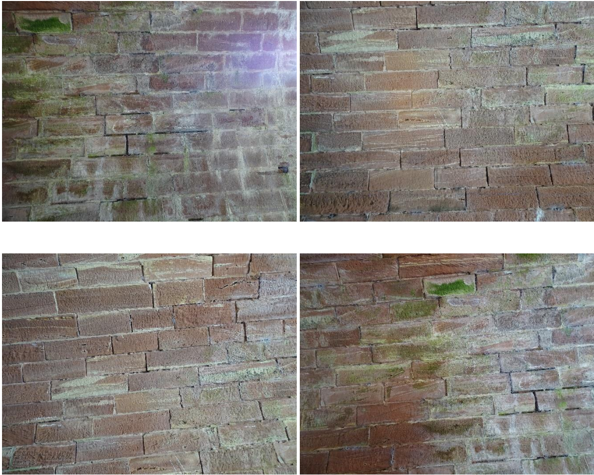
Abb. 66: Gegenwärtiger Zustand mit erkennbaren Fledermausversteckmöglichkeiten im Mauerwerk.
