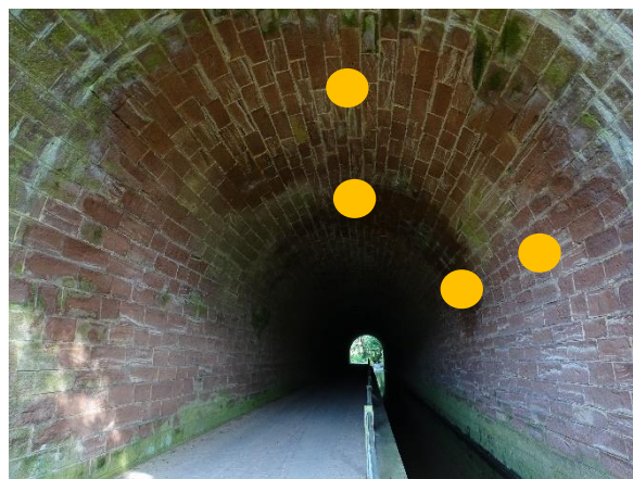
Abb. 60: Entlang des Gewölbescheitels und an der gewässerseitigen Wand müssen Fledermaus-Deckensteine und Flachkästen angebracht werden (hier symbolhaft mit gelben Punkten markiert).
