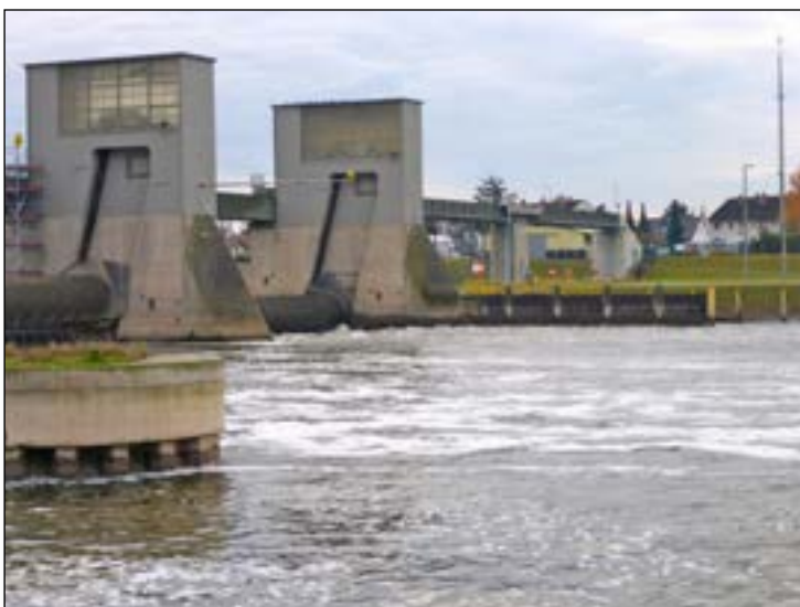
Abb. 20b: Angehobene Wehrwalze (um 62 cm) auf der linken Uferseite; Durchfluss 118 m 3 /s (22.11.2016).
