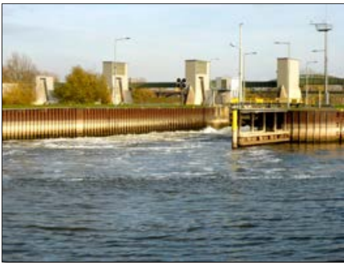
Abb. 20a: Auslaufbereich der rechten Schiffsschleusenkammer Staustufe Kostheim beim Öffnen des Schützes (November 2015).
