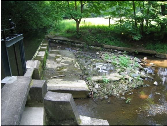
Abb. 12: Wehr der WKA zwischen Lorsbach und Eppstein mit ungenügender Mindestwasserdotierung; im Hintergrund der veraltete Fischpass (Sommer 2007).
