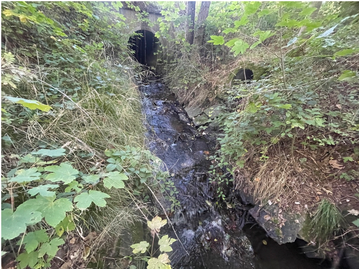
Abbildung 21: Der Auslauf des Durchlassbauwerks (Photo R. Hennings, IMG_7318, 27.9.2023)
