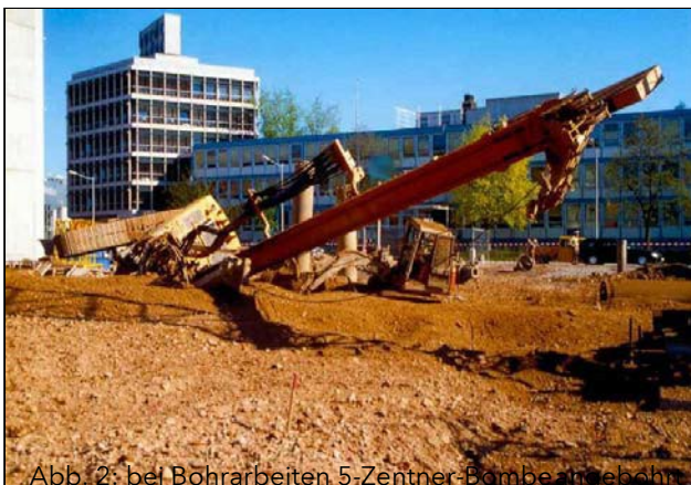
Abb. 2: bei Bohrarbeiten 5-Zentner-Bombe angetroffen
