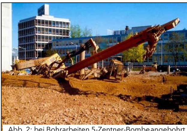
Abb. 2: bei Bohrarbeiten 5-Zentner-Bombe angebohrt
