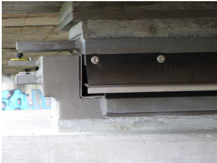
Hohlraum hinter Gummidichtung des Lagers auf Pfeilerkopf
