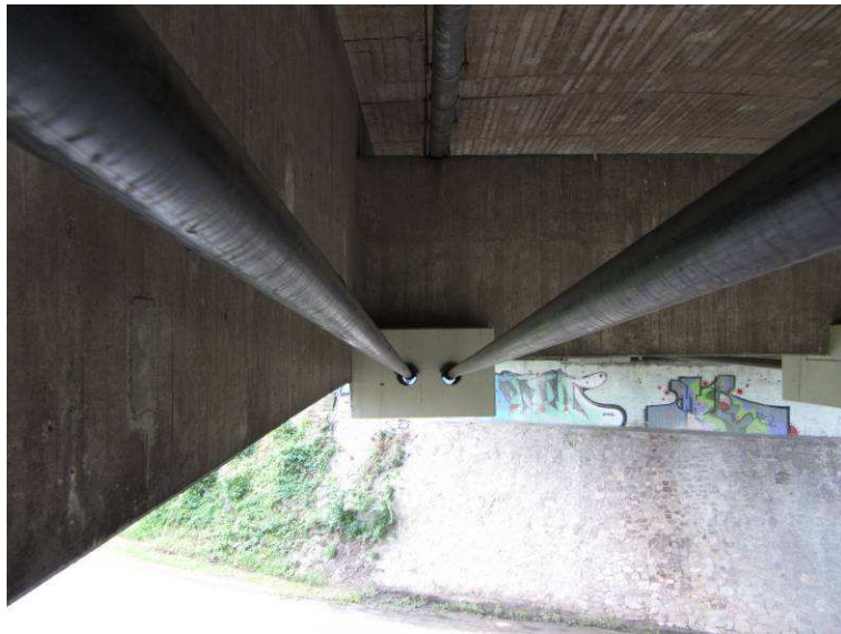
beidseitig offene Durchlässe der Seilzüge
