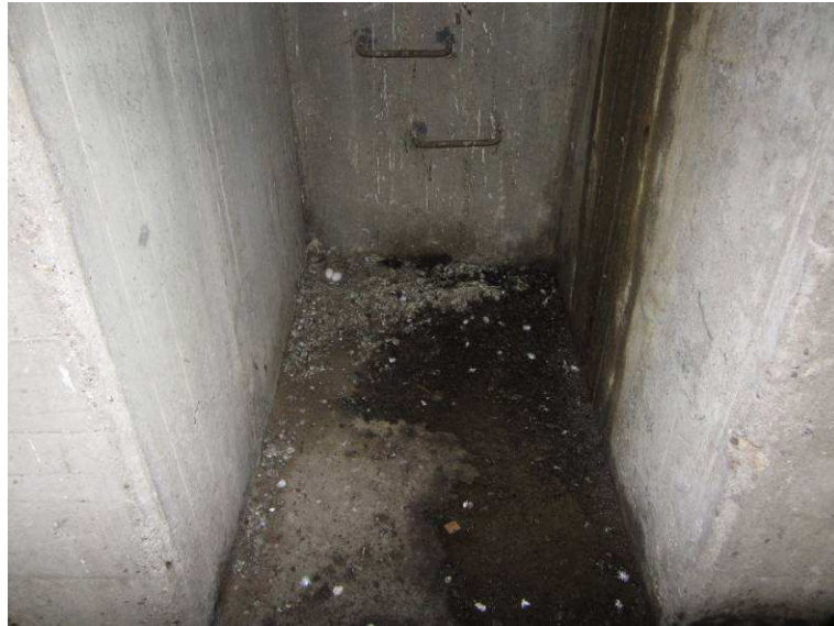
Nest einer Straßentaube im östlichen Widerlager
